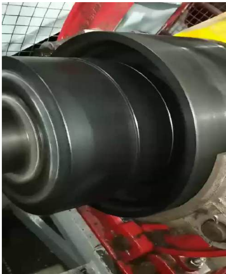
国家能源集团伊犁电厂 皮带机系统
