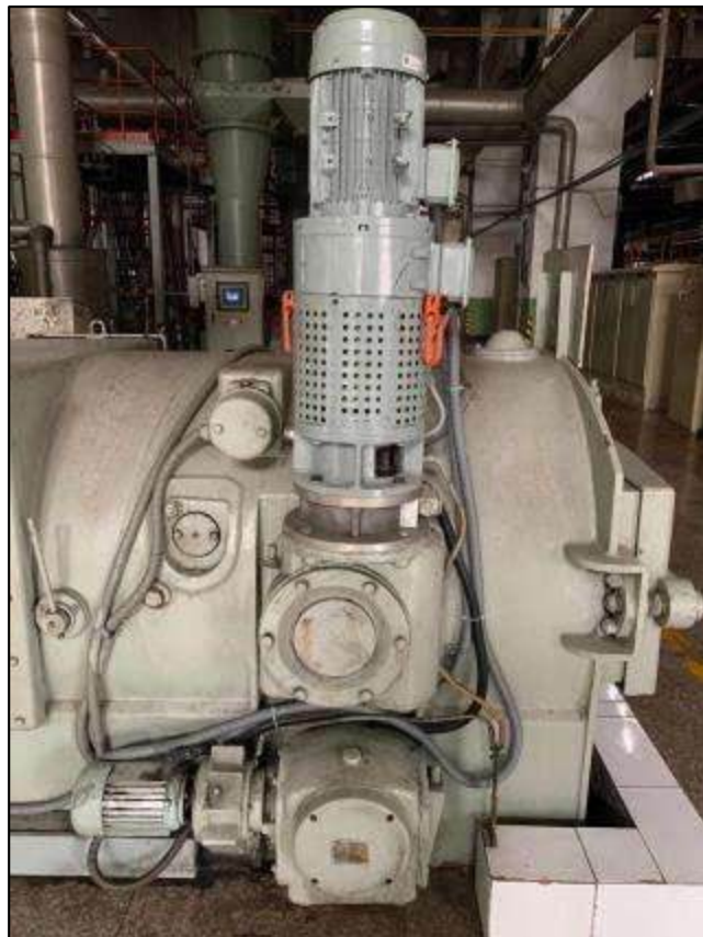
国家能源集团谏壁发电厂现场图
