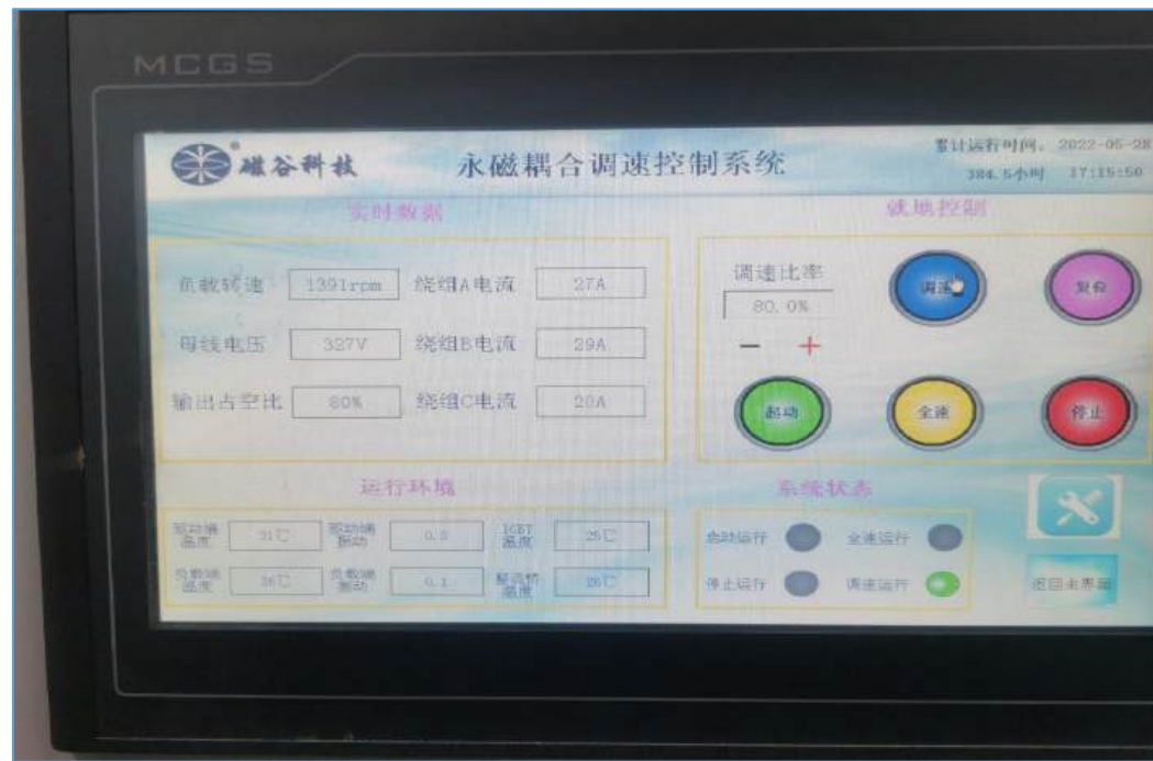
长兴电厂现场运行数据
