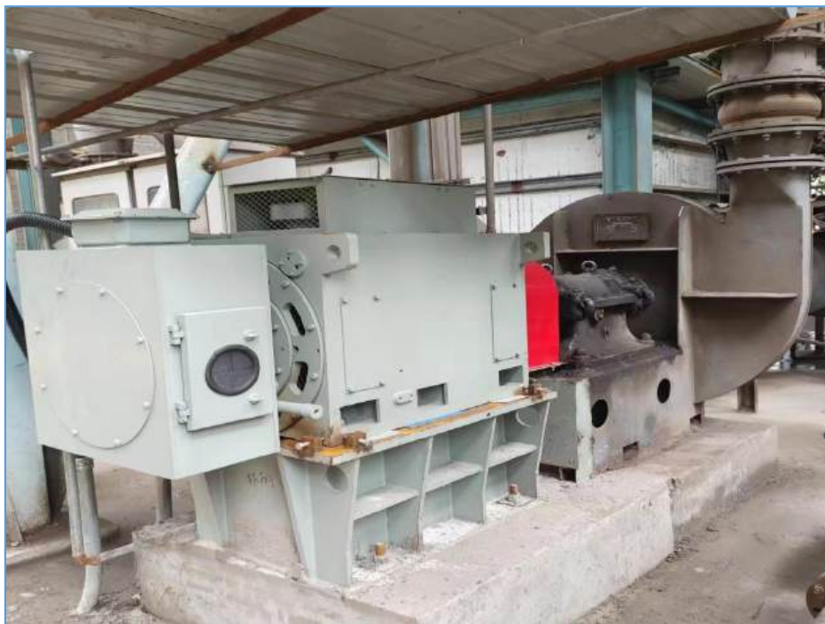
杭丽热电现场图
